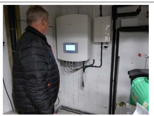
Bergvärmecentral med 5 pumpaggregat Solcellskontroll
